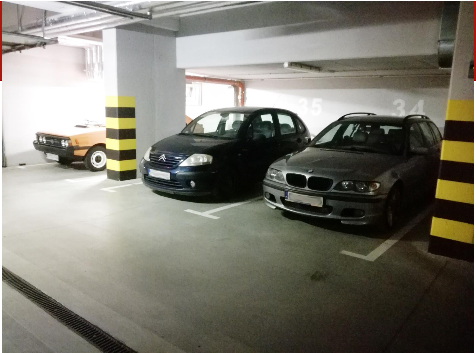
Obciążenie stropu parkingu pojazdami.
