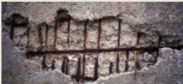
Rys. 1. Uszkodzenie elementu konstrukcyjnego w skutek karbonatyzacji
