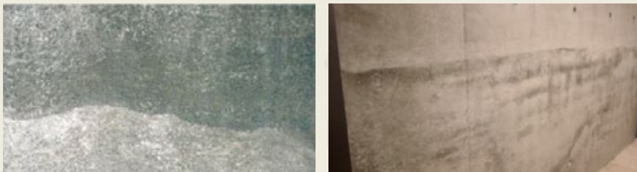
Rys. 5. Powierzchnia betonu z widoczną różnicą w odcieniach spowodowaną brakiem stałości konsystencji
