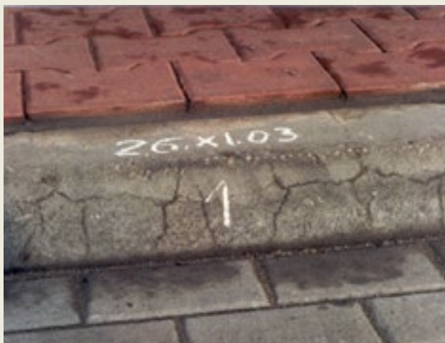
Rys. 4. Uszkodzenia betonu na skutek działania mrozu.
