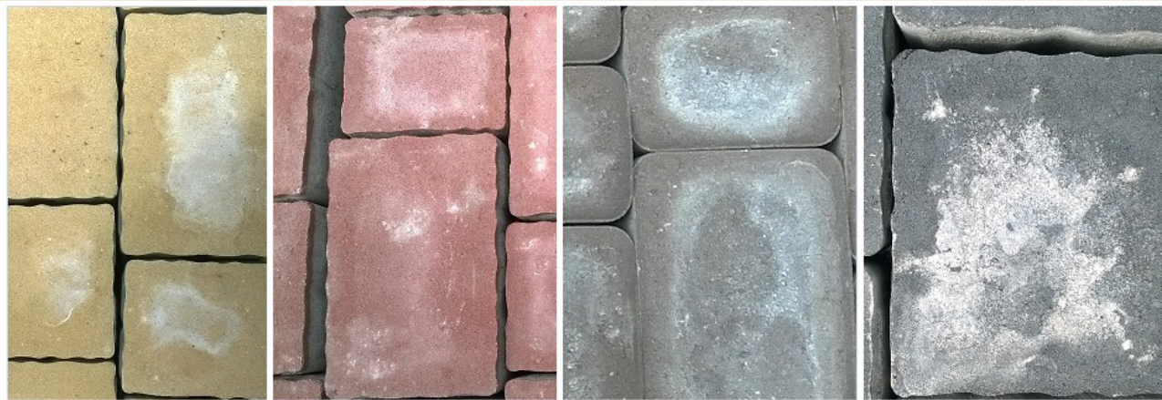
Rys. 1. Wykwity węglanowe na powierzchni kostki brukowej
