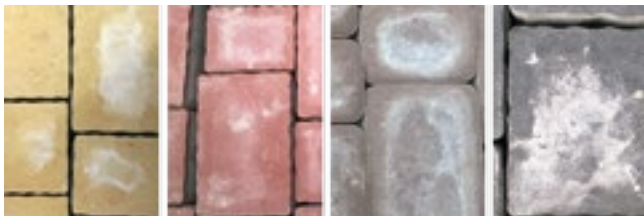
Rys. 6.102. Wykwity węglanowe na powierzchni kostki brukowej
