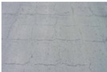
Rys. 6.88. Skurcz plastyczny zabudowanego betonu
