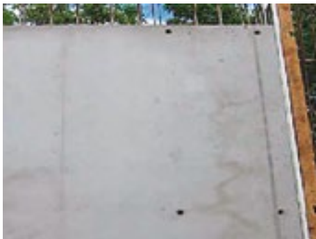
Rys. 6.80. Przebarwienia betonu spowodowane nierównomiernym nałożeniem środka antyadhezyjnego
