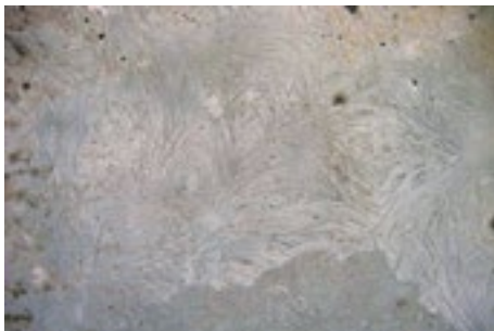
Rys. 6.100. Uszkodzenie powierzchni betonu wskutek przemrożenia
