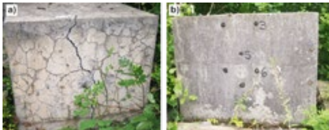
Rys. 6.63. Reakcja ASR, a) przykład destrukcji betonu zwykłego, b) beton z dodatkiem popiołu lotnego
