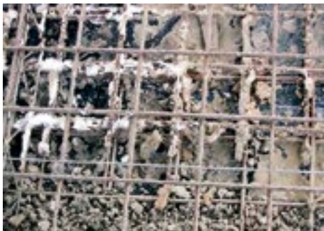
Rys. 6.86. Błędy zabudowy mieszanki betonowej – oblodzone zbrojenie
