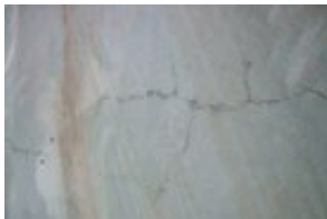
Rys. 6.90. Uszkodzenie powierzchni betonu na skutek „szoku” termicznego
