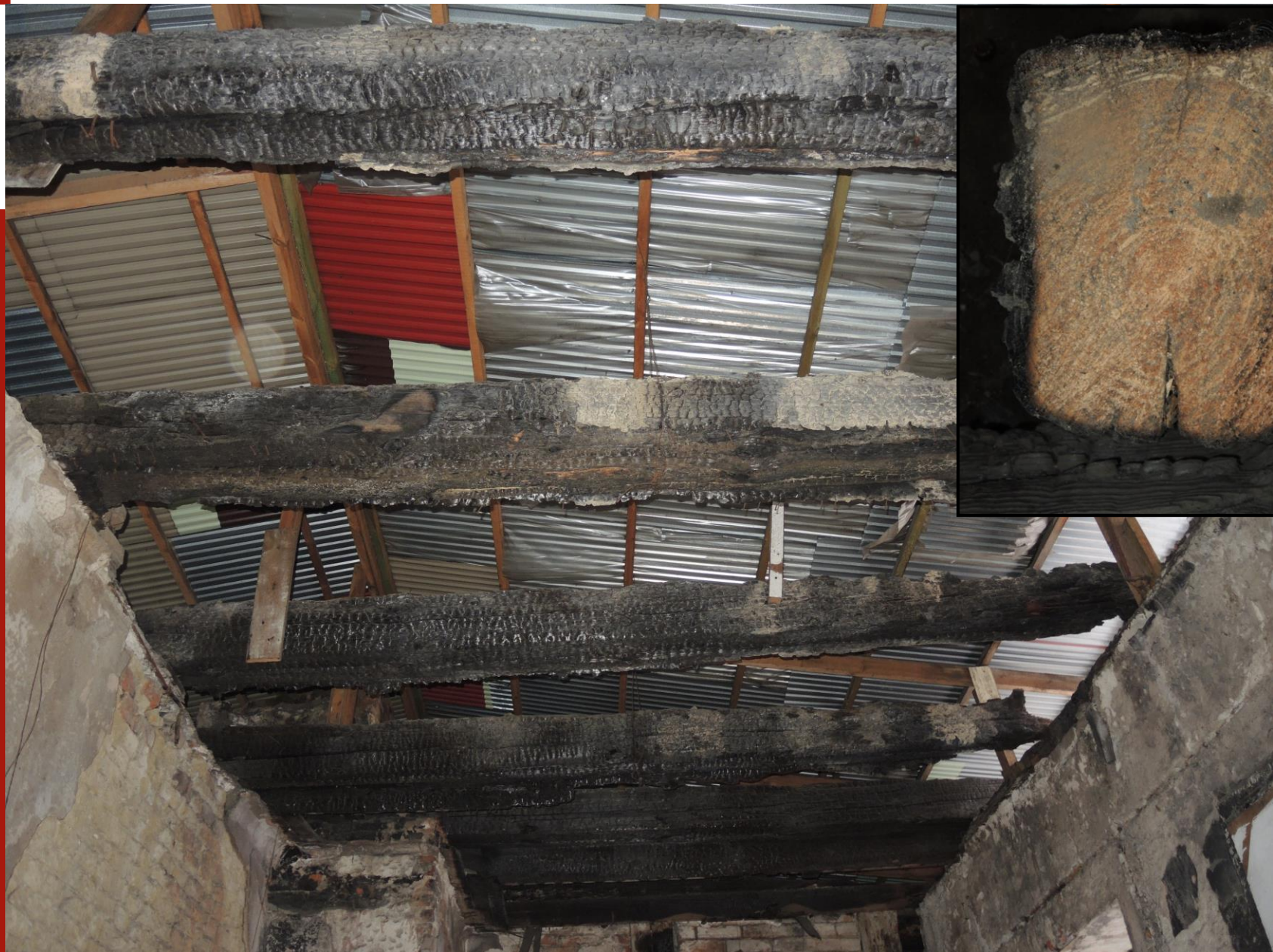
Drewniany strop po pożarze budynku.
