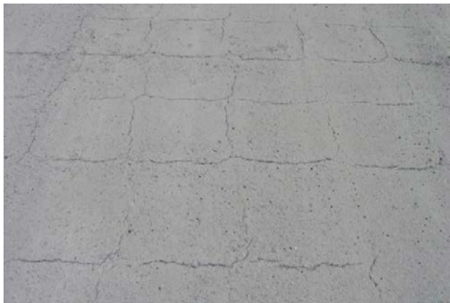
Rys. 5.175. Zarysowanie powierzchni w efekcie skurczu plastycznego
