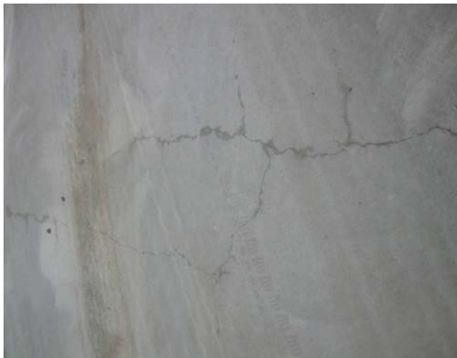
Rys. 5.178. Uszkodzenie powierzchni betonu na skutek „szoku” termicznego
