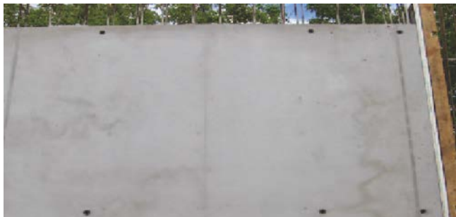
Rys. 5.166. Przebarwienia betonu spowodowane nierównomiernym nałożeniem środka antyadhezyjnego
