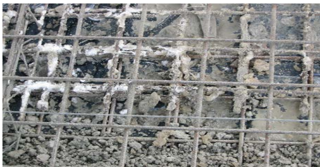
Rys. 5.173. Błędy zabudowy mieszanki betonowej – oblodzone zbrojenie
