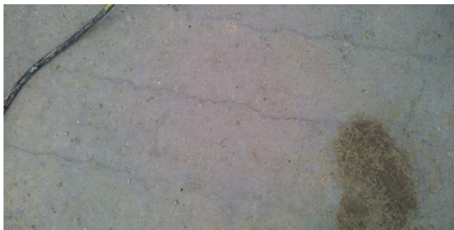
Rys. 5.65. Rysy na powierzchni betonu wskutek osiadania plastycznego
