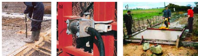
Rys. 5.170. Wibrowanie mieszanki betonowej a) wibratorem buławowym, b) wibratorem przyczepnym, c) wibratorem powierzchniowym
