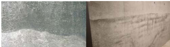
Rys. 5.123. Powierzchnia betonu z widoczną różnicą w odcieniach spowodowaną brakiem stałości konsystencji
