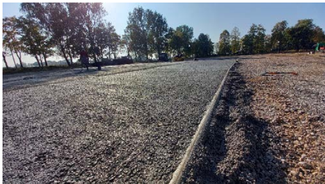
Rys. 3.64. Beton jamisty jako warstwa drenażowa pod boisko sportowe – zastosowano CEM III/A 42,5N-LH/HSR/NA
