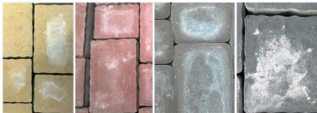
Rys. 5.203. Wykwitki węglanowe na powierzchni kostki brukowej
