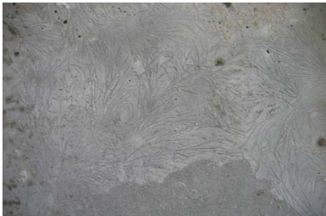
Rys. 5.197. Uszkodzenie powierzchni betonu wskutek przemrożenia
