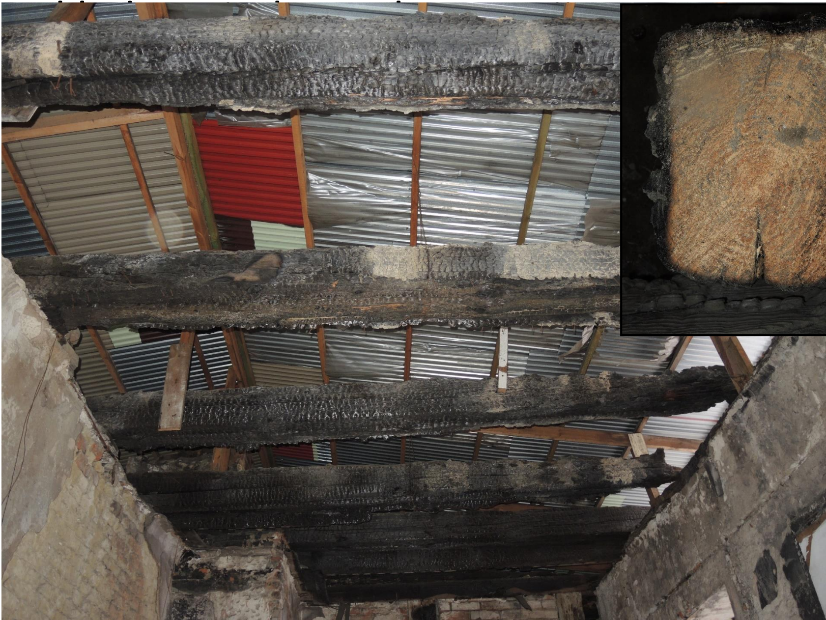
Drewniany strop po pożarze budynku.
