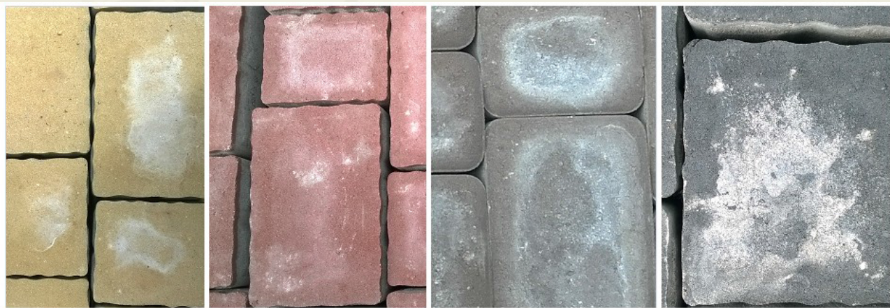
Rys. 1. Wykwity węglanowe na powierzchni kostki brukowej
