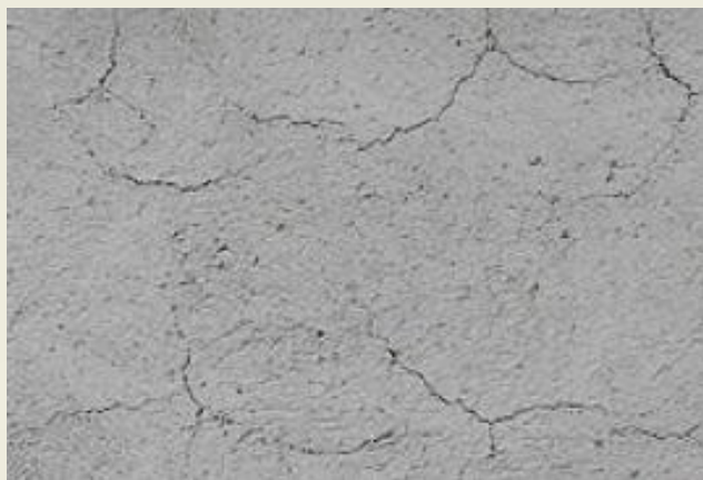
Rys. 2. Rysy skurczowe powstałe w wyniku nieprawidłowo prowadzonej pielęgnacji
