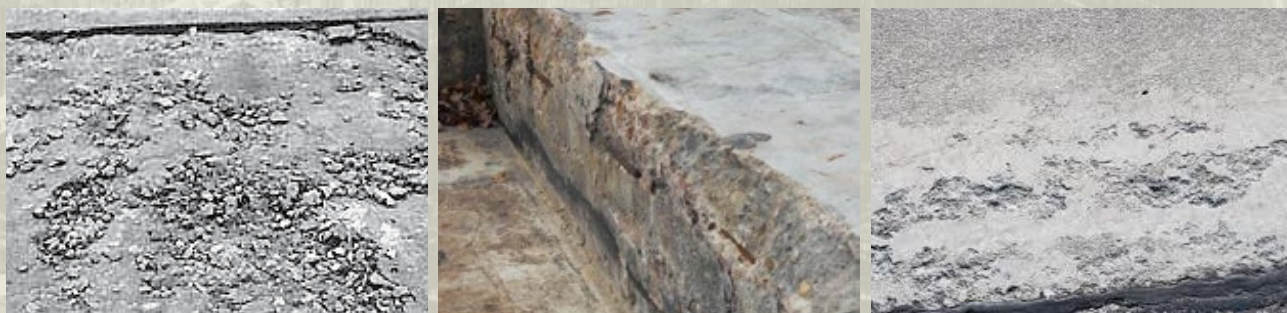
Rys. 1. Przykłady destrukcji betonu wskutek agresji mrozowej
