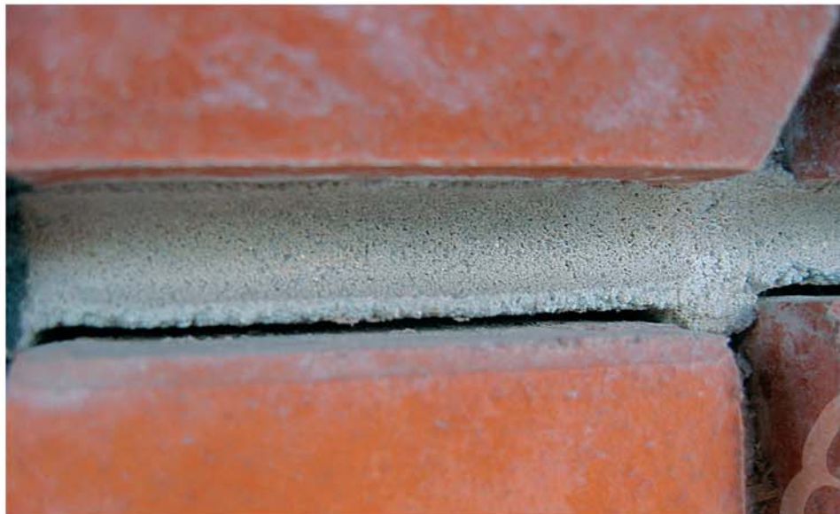
Zdjęcie 1. Zaprawa bez wapna – słaba przyczepność zaprawy do podłoża ułatwia dostawanie się wody do wnętrza muru.
