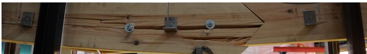
Rys. 5.28. Obraz zniszczenia belki D03
