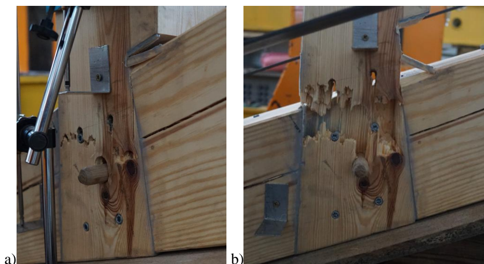
Rys. 5.152. Obrazy zniszczenia połączenia W03: a) inicjacja zniszczenia drewna w przekroju rozciągającym (widoczne osłabienia przekroju: otwory przy wprowadzonych łącznikach trzpieniowych oraz przy kolku, widoczny sęk), b) całkowite zniszczenie przekroju drewnianego
