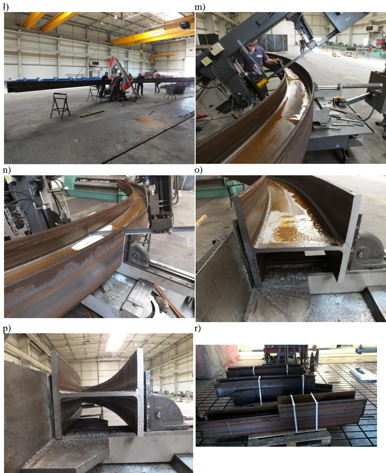
Rys. 4.3.cd Kolejne etapy gięcia na zimno elementu i podział na segmenty badawcze: widok elementu podczas rozcinania, m) piła taśmowa do wykonania przecięcia elementu na segmenty, n) widok belki podczas przecinania, o) widok płaszczyzny przecięcia belki, k) widok płaszczyzny przecięcia belki, p) widok od czoła elementu po przecięciu, r) segmenty dostarczone do badań materiałowych
