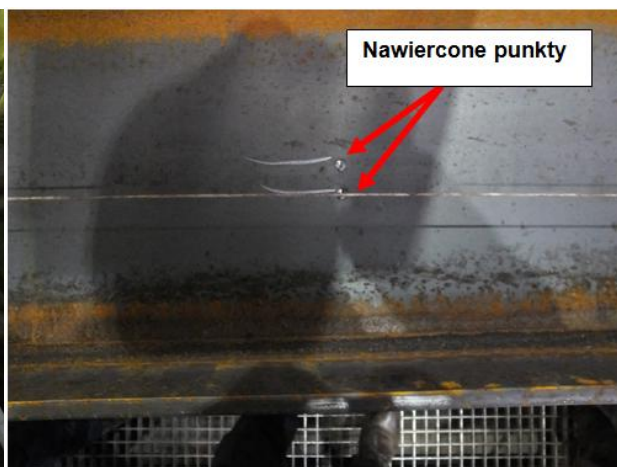
Rys. 2.22. Widok przesunięcia belki względem osi pierwotnej [zdjęcie: Autor]
