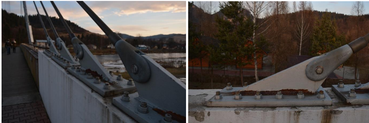
Rys. 1.3. Zamocowanie widelcowe want odciągowych (z prętów pełnych) w kładce przez Dunajec w Sromowcach Niżnych oraz widoczne zaniedbania utrzymaniowe w roku 2016
