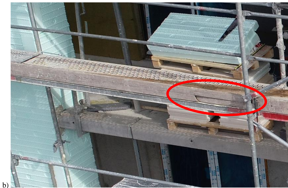
Rys. 4.2 Widok na uszkodzoną: a) poręcz górną balustrady, b) belkę krawężnikową (opracowanie własne z wykorzystaniem BSP)
