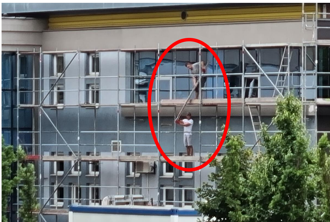
Rys. 4.3 Widok na pracowników montujących rusztowanie budowlane, nieposiadających odpowiednich środków ochrony indywidualnej (opracowanie własne)
